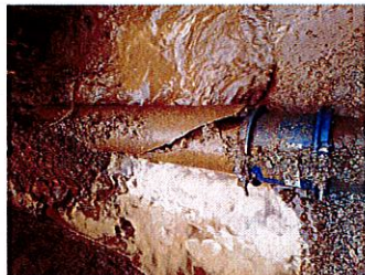
Photo : conduite en amiante ciment entre Tavaria et Portigliolo
