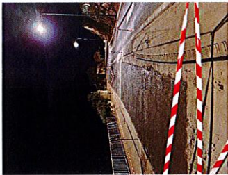
Photo : Fuite sur conduite en amiante ciment devant le cimetière de Propriano
